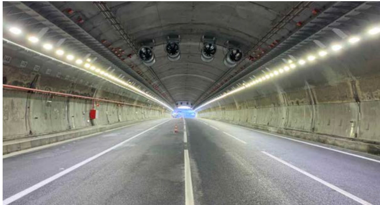
Instalações elétricas no Tunel de Montemor, MEEC.
